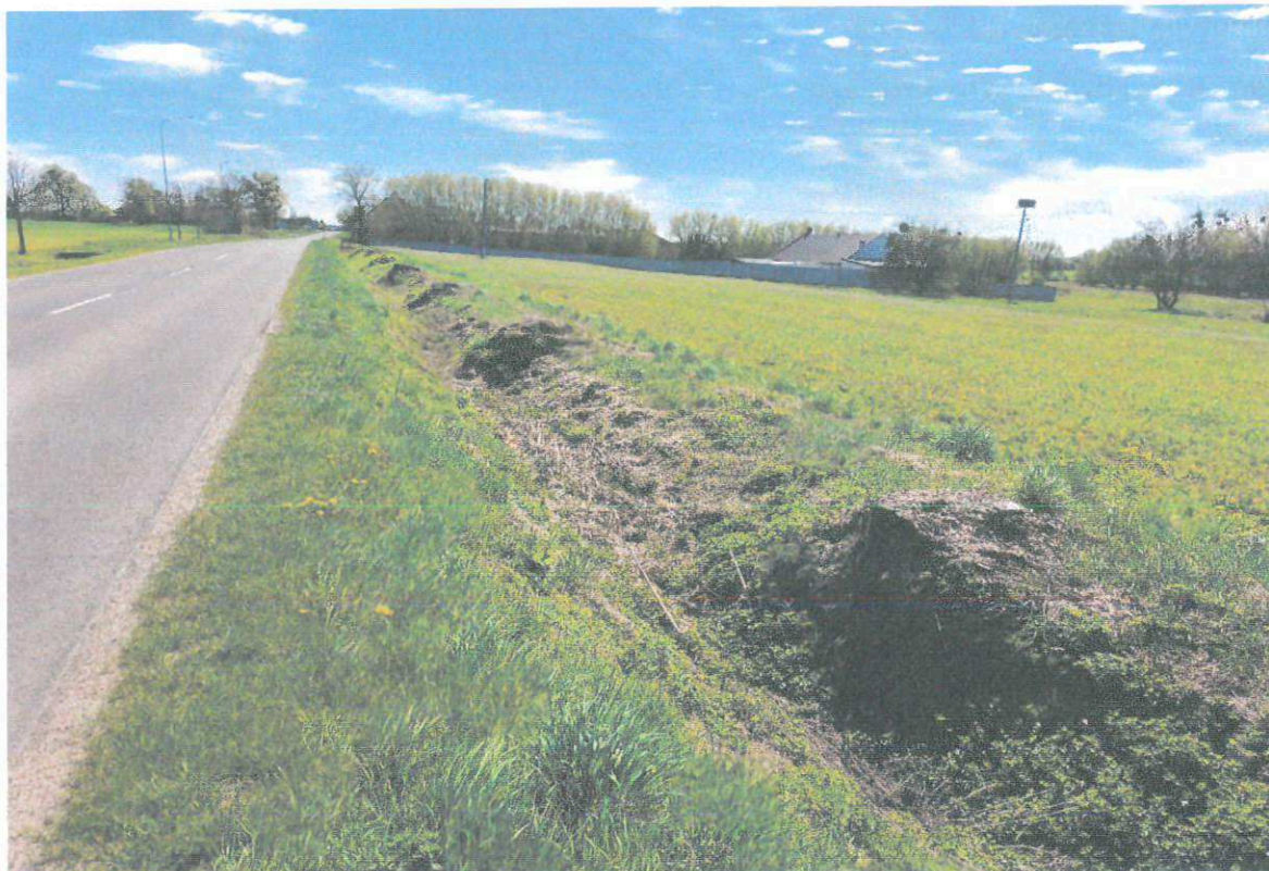
Zdj. 1 Obecny stan drogi
