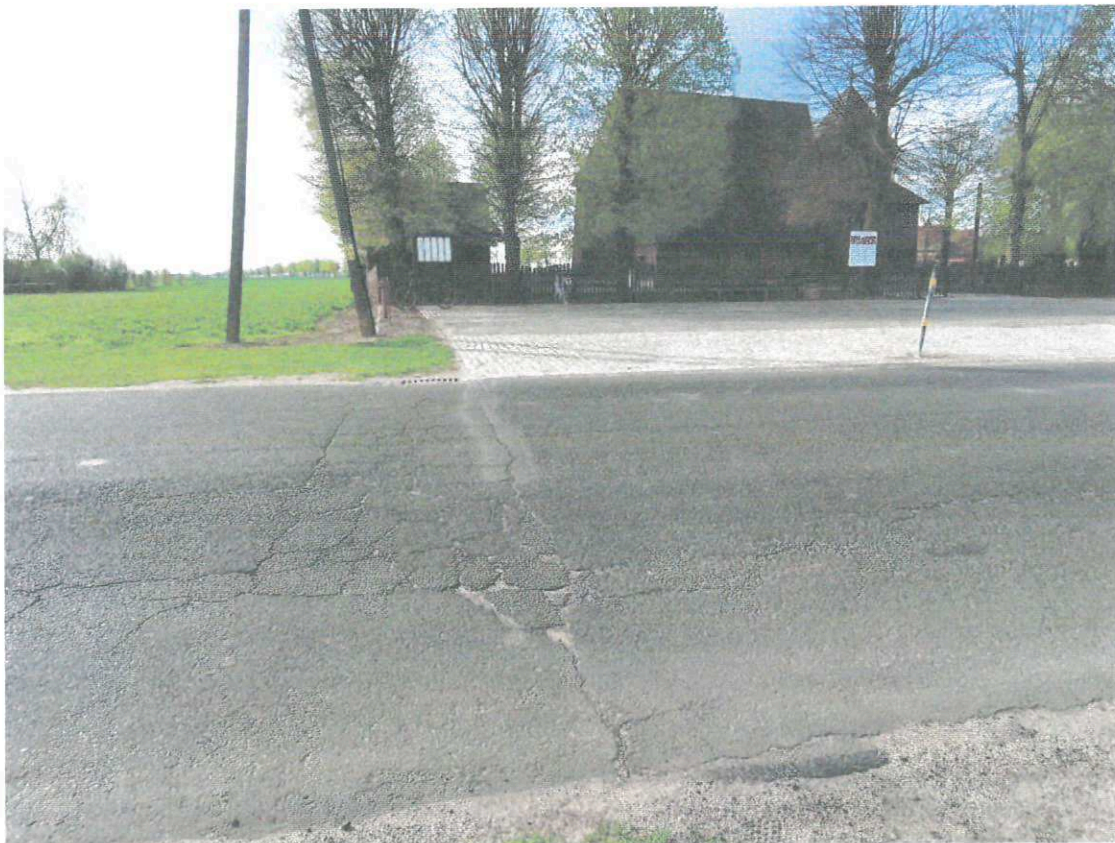
Zdj. 1 Obecny stan drogi
