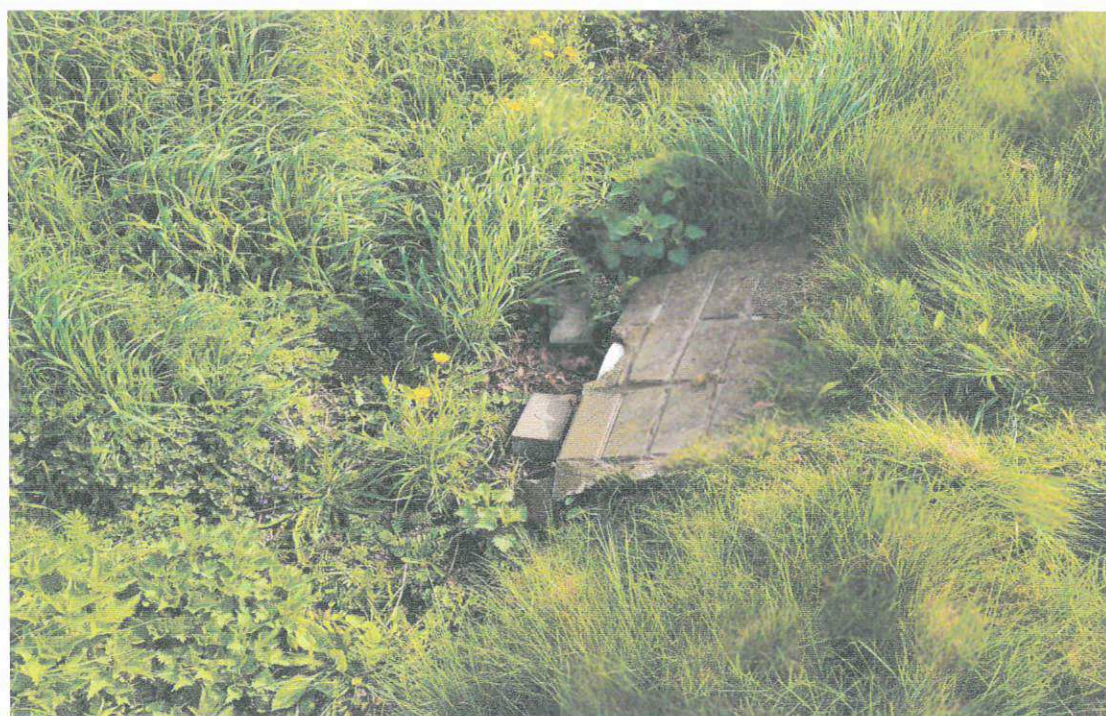
Zdj. 3 Obecny stan drogi
