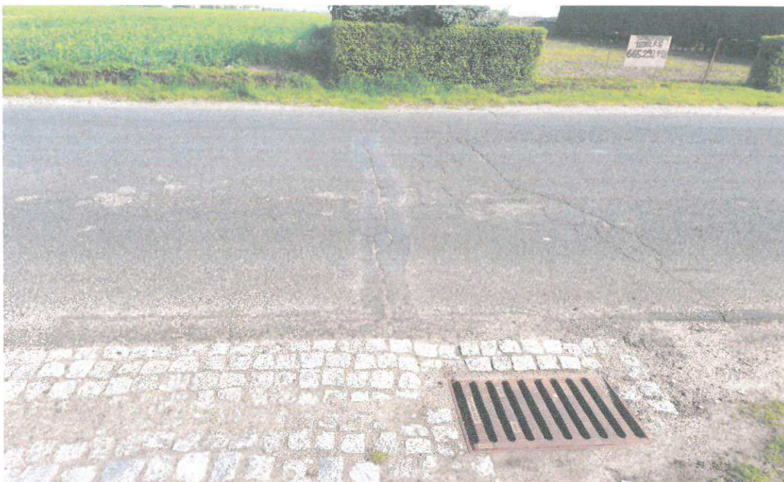
Zdj. 2 Obecny stan drogi
