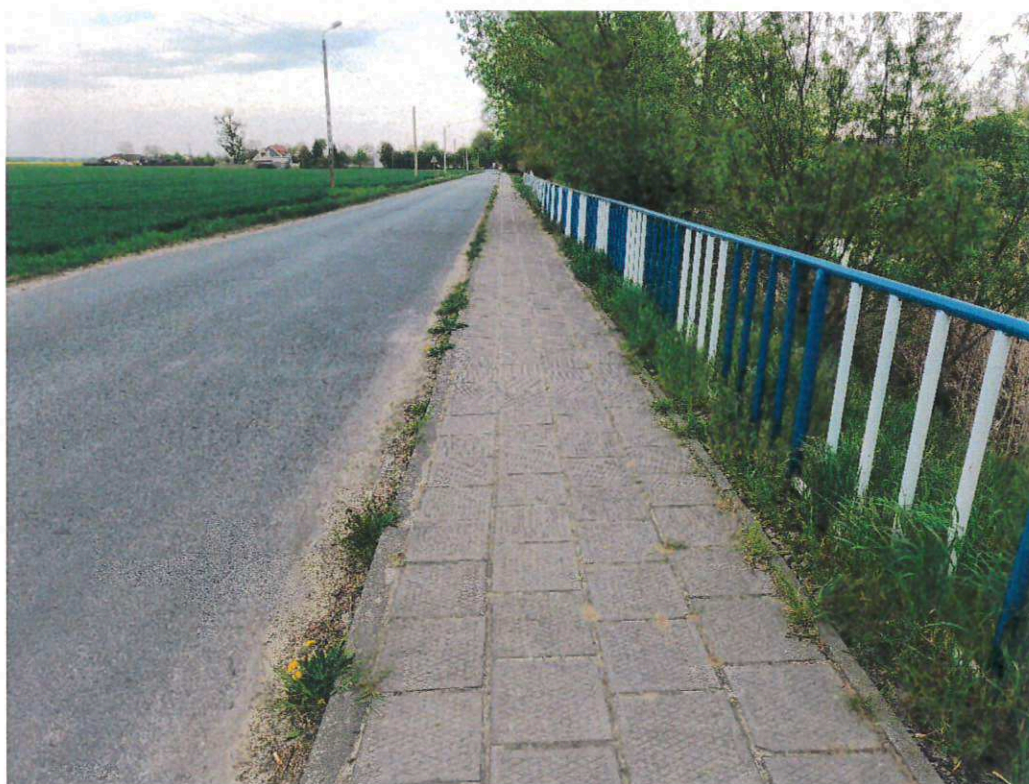
Zdj. 3. Obecny stan chodnika
