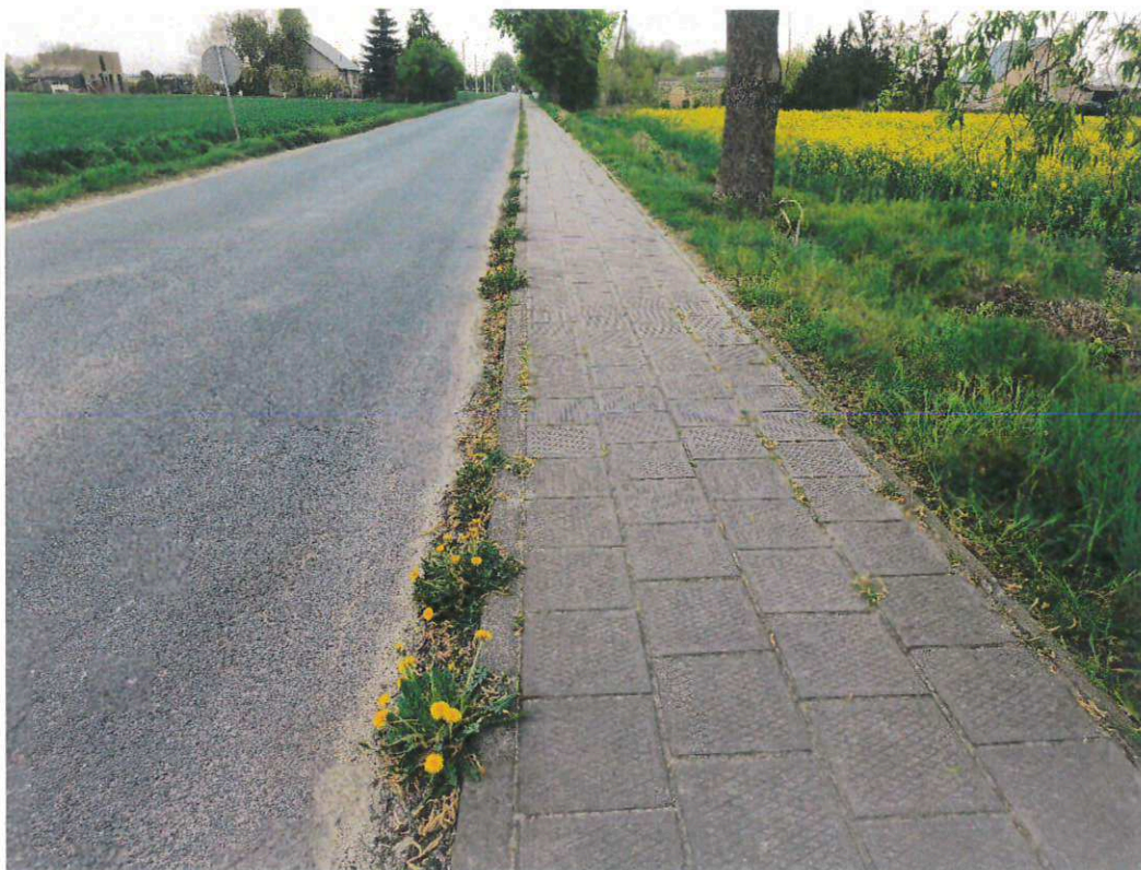
Zdj. 2. Obecny stan chodnika
