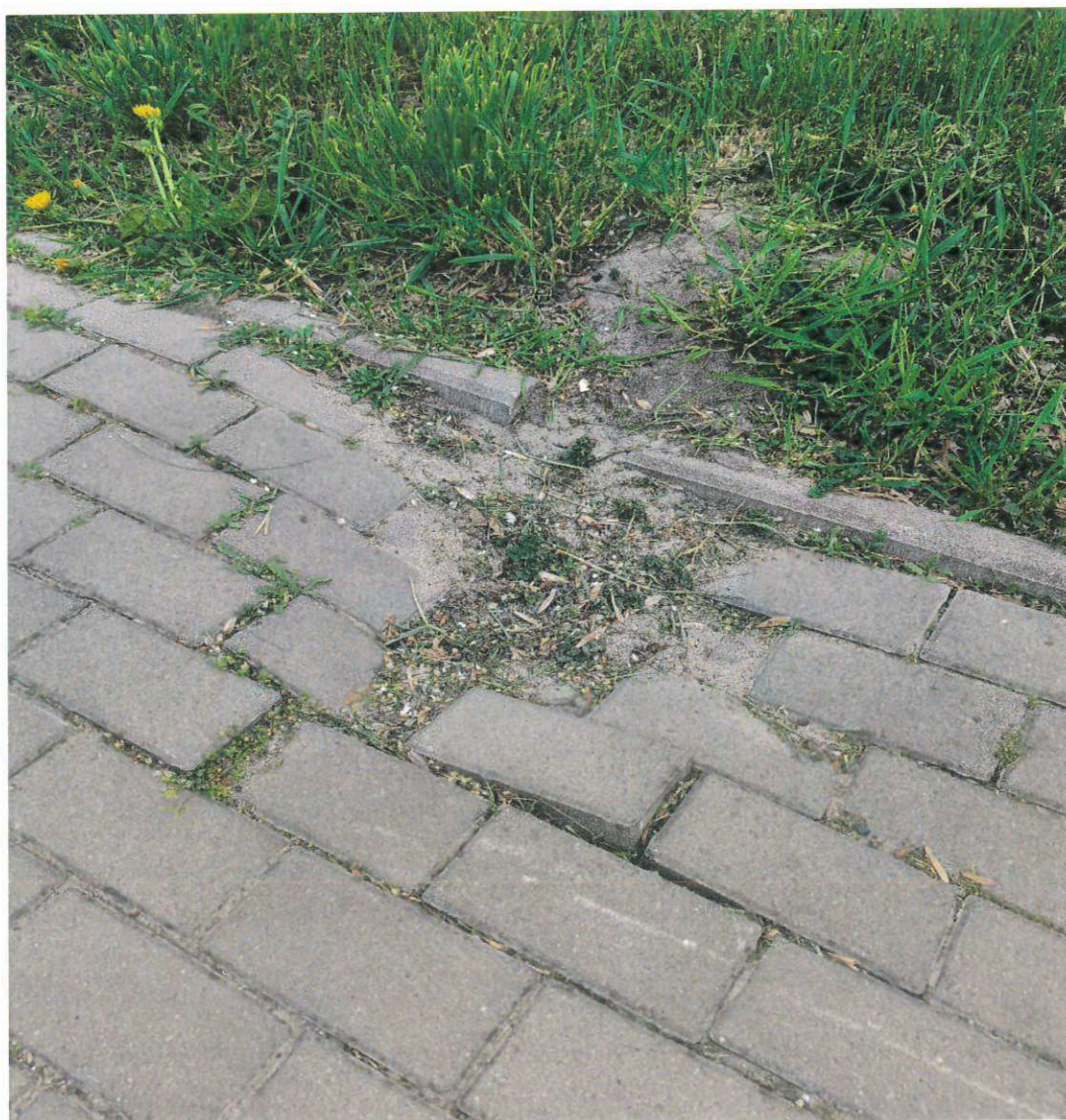
Zdj. 1. Obecny stan chodnika
