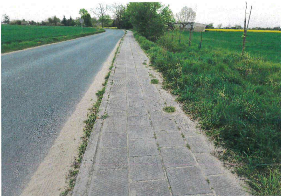
Zdj. 4. Obecny stan chodnika
