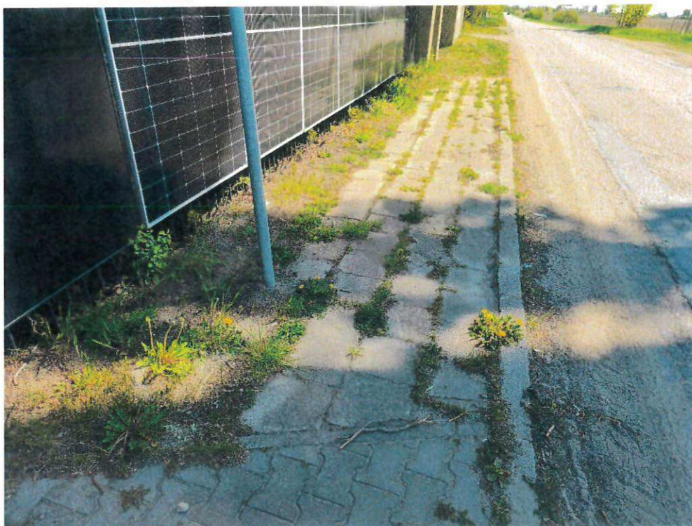
Zdj. 1. Obecny stan chodnika
