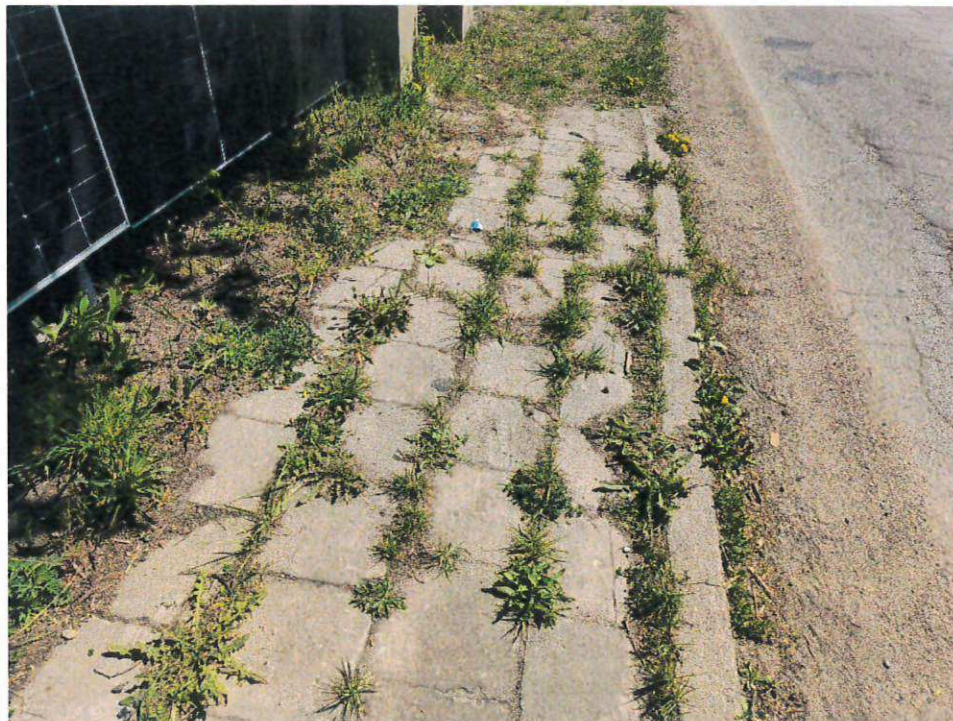
Zdj. 3. Obecny stan chodnika
