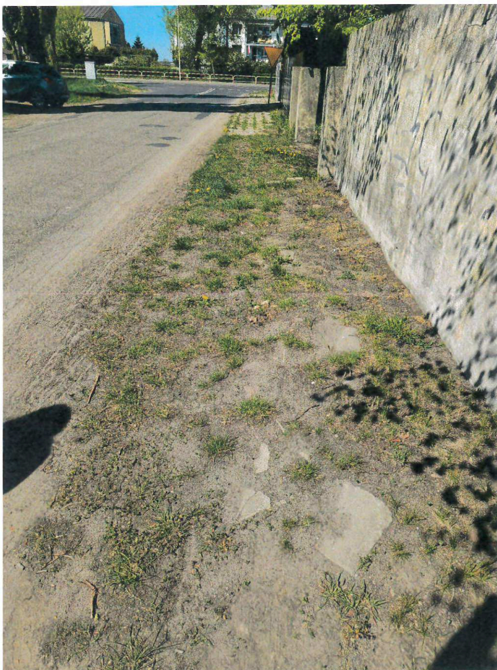
Zdj. 4. Obecny stan chodnika
