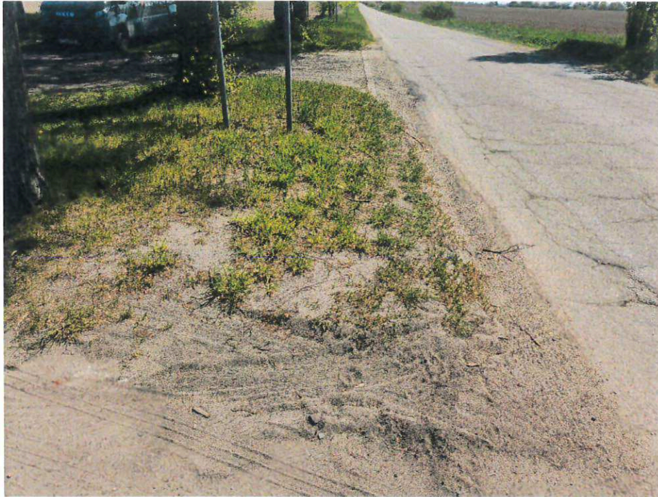
Zdj. 2. Obecny stan chodnika
