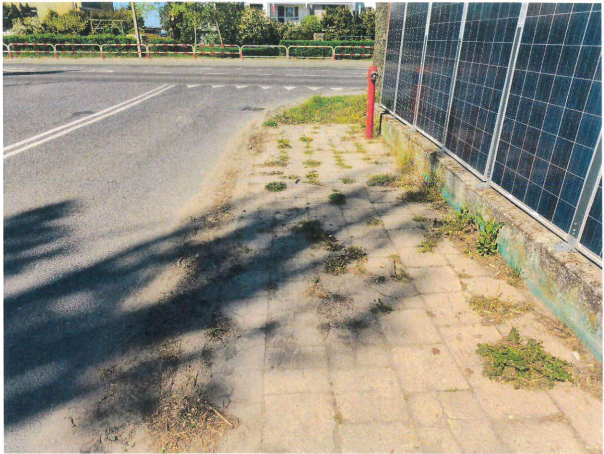
Zdj. 5. Obecny stan chodnika.
