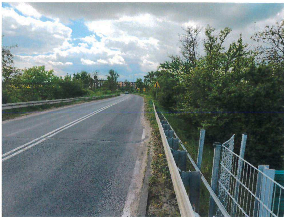
Zdj. 10. Obecny stan wiaduktu
