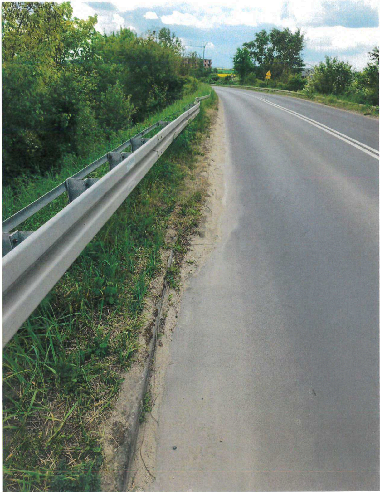
Zdj. 3. Obecny stan wiaduktu
