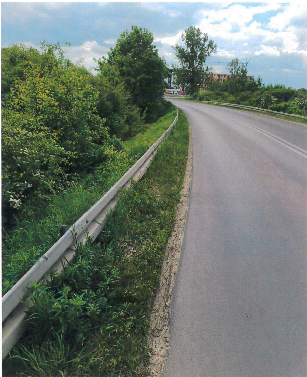
Zdj. 4. Obecny stan wiaduktu.
