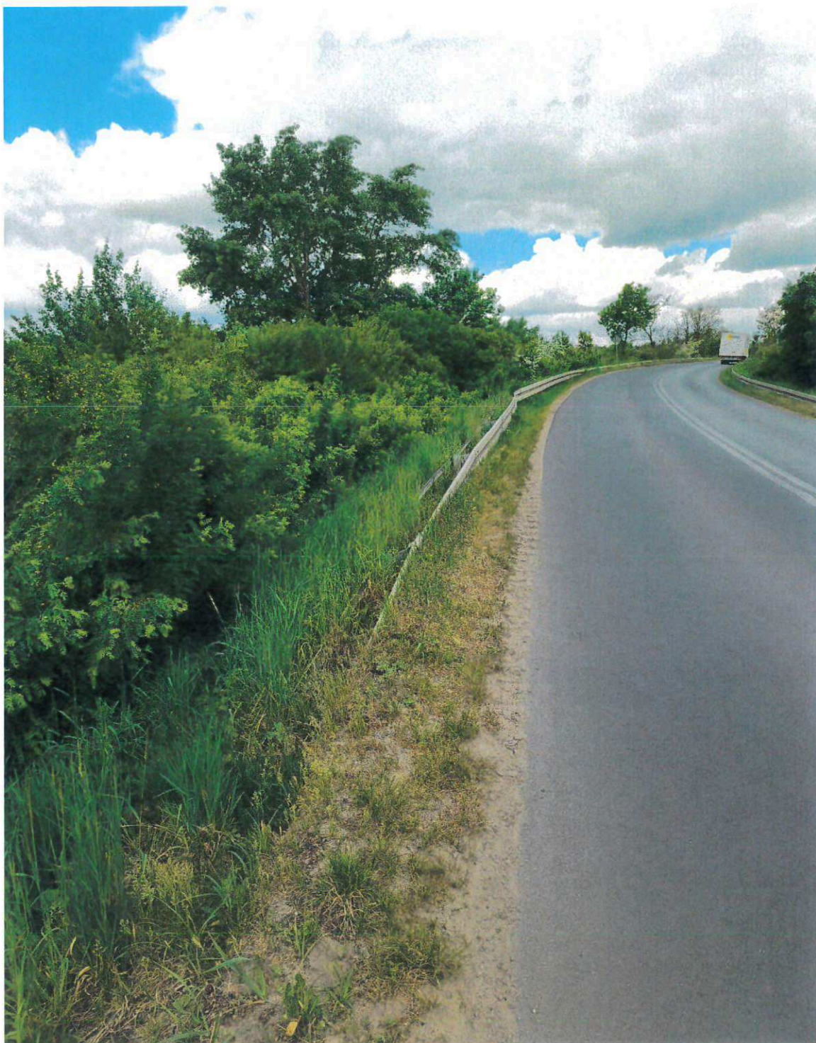
Zdj. 9. Obecny stan wiaduktu
